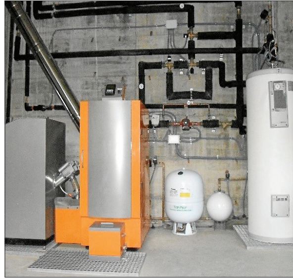
Instal·lació formada per diferents calderes i aparells
